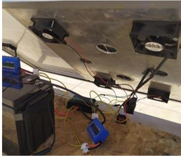
Şekil 2.15. Hava Akımı İle Soğutma Sistemi
