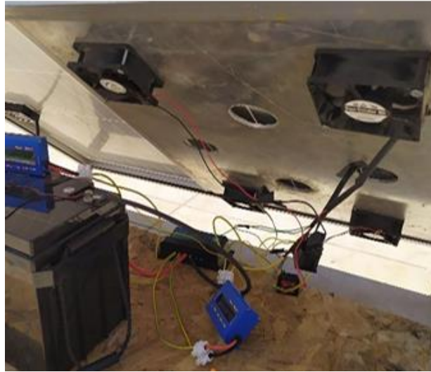
Şekil 2.15. Hava Akımı İle Soğutma Sistemi
